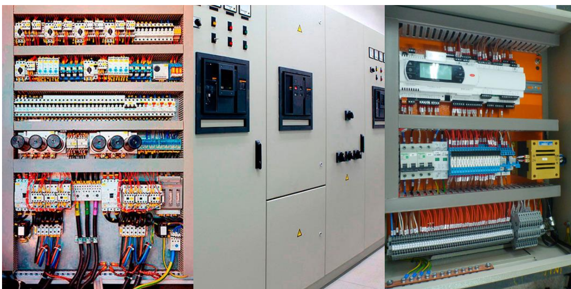
Figura 4-46: Painéis de controle e automação. Fonte: Orbita Eletricidade, 2024.
