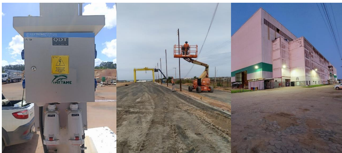
Figura 4-43: Instalações elétricas. Fonte: Acervo Imetame.
