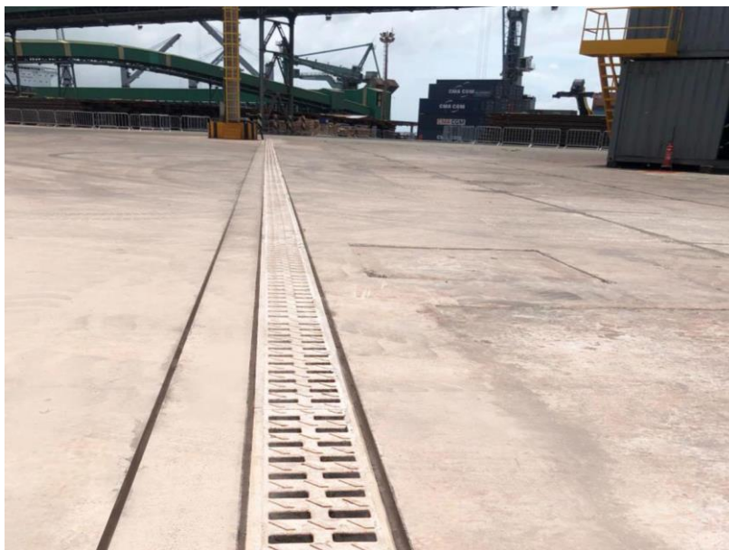
Figura 4-33: Canais de drenagem instalados no Porto de Itaqui, São Luís/MA.
