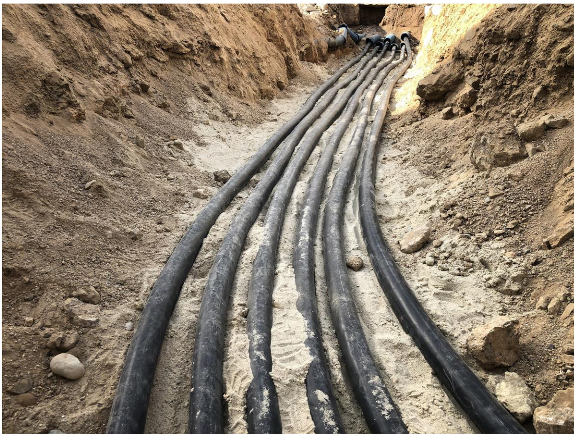
Figura 4-45: Passagem de cabos subterrâneos. Fonte: Ibilux, 2024.
