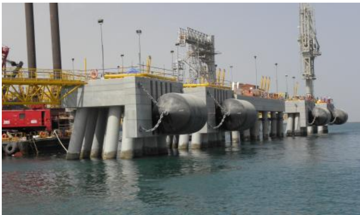
Figura 4-72: Defensas instaladas em berços de atracação.
