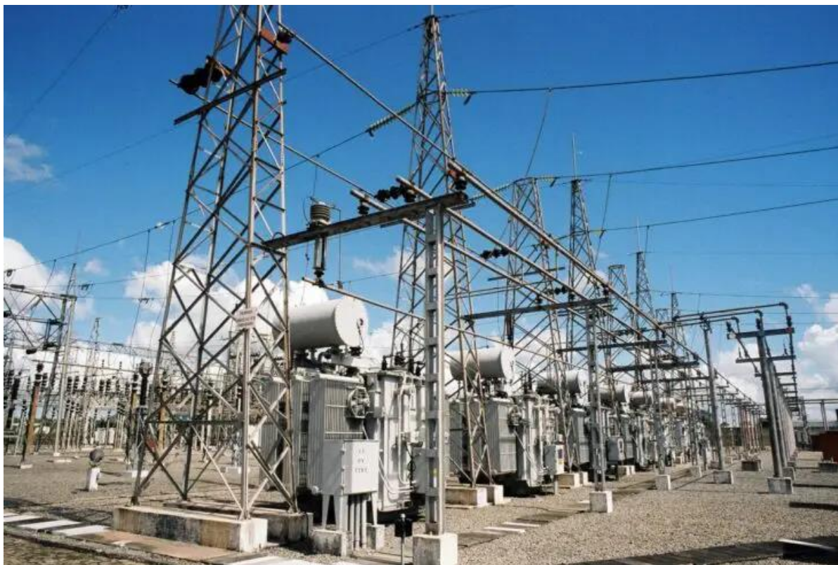
Figura 4-49: Subestação Elétrica. Fonte: Click Petróleo e Gás, 2021.
