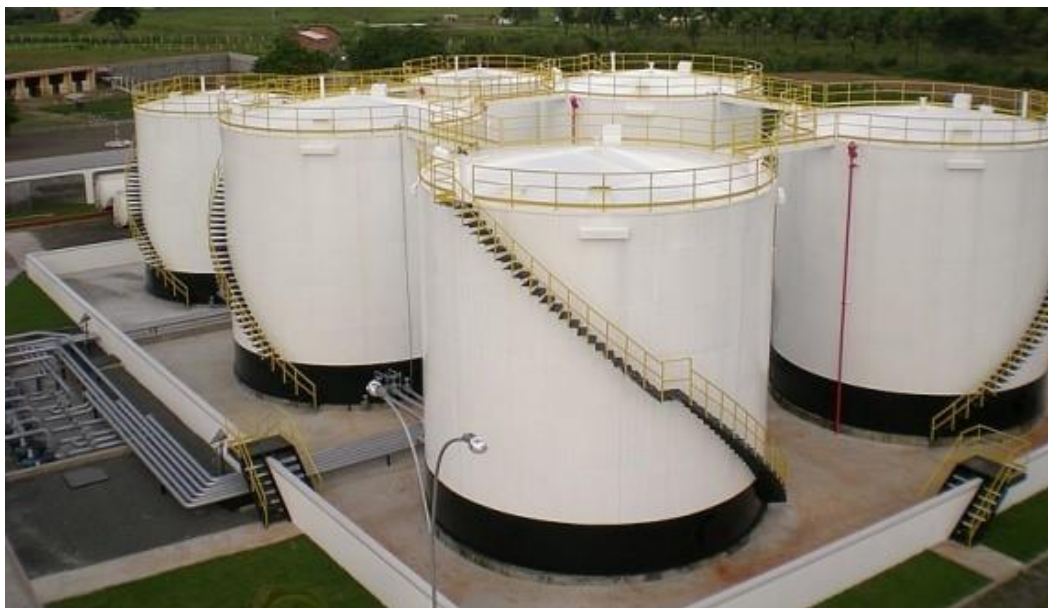
Figura 4-77: Pátio de tancagem dentro de bacia contenção. Fonte: Projetap, 2024.
