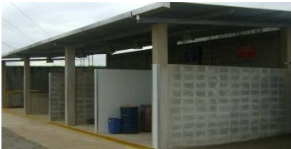
Figura 4-106: Exemplo de central de armazenamento de resíduos. Fonte: EIA/RIMA Imetame Logística Porto (2011).
