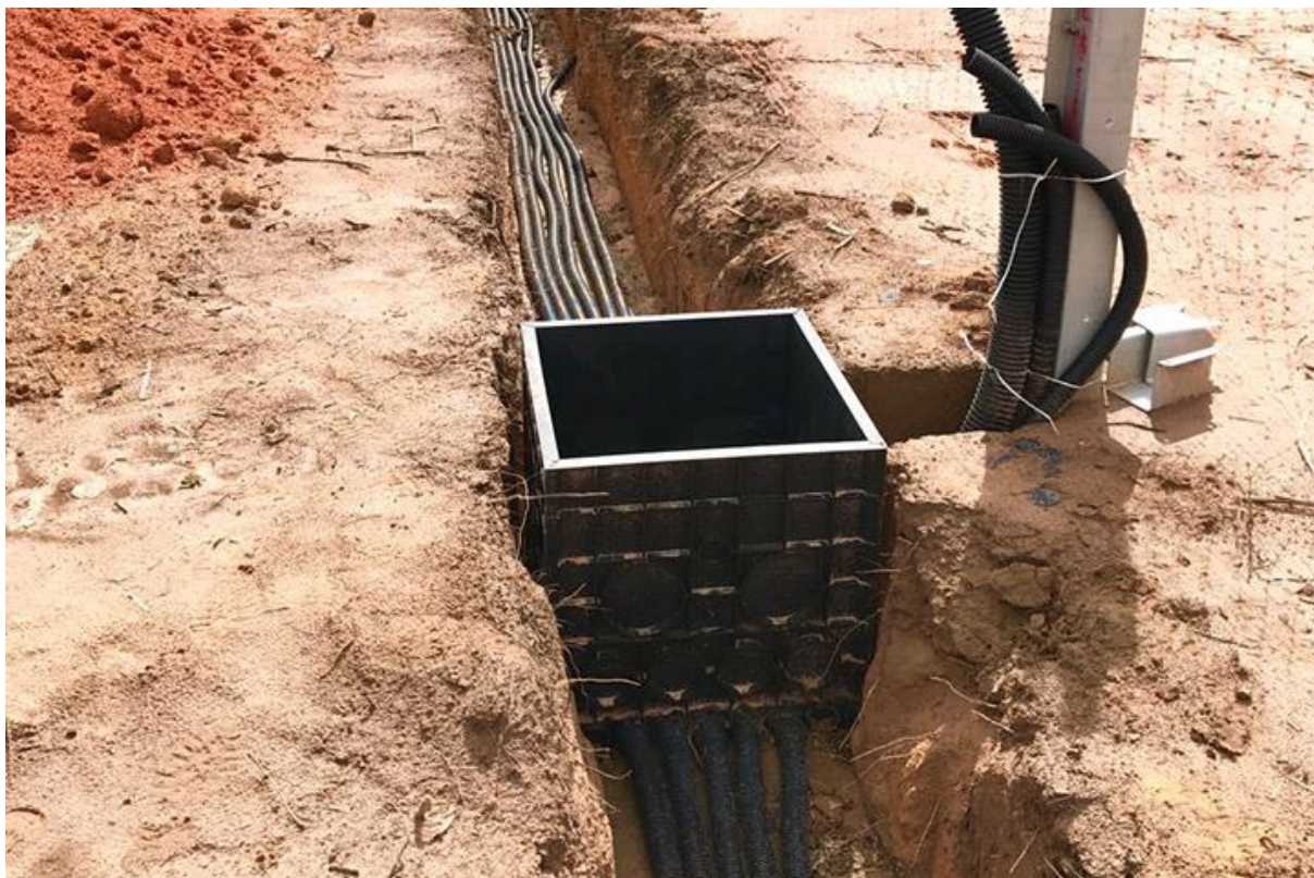
Figura 4-44: Infraestrutura para instalações elétricas. Fonte: Fuminas, 2024.
