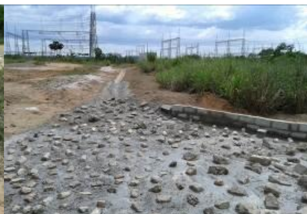
Foto 3-32: Fim da sarjeta de escoamento em área de bota-fora. Fonte: Acervo Dossel, 2015.
