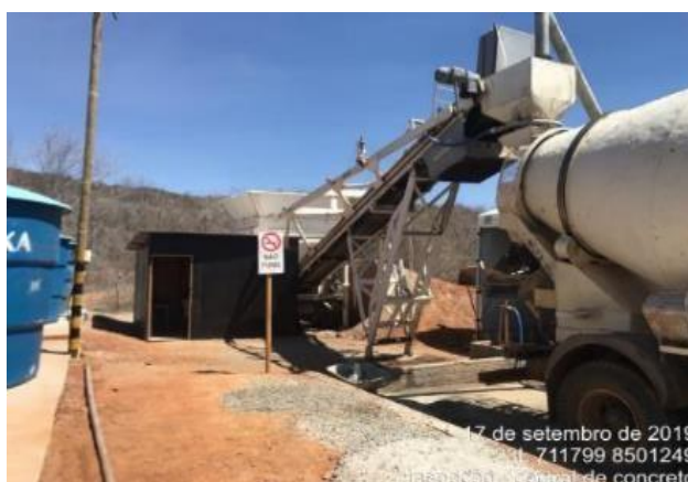
Foto 3-7: Placa de sinalização presente em central dosadora. Fonte: Acervo Dossel, 2019.
