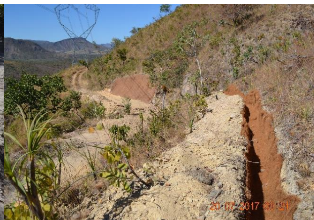
Foto 3-8: Exemplo de sistema de drenagem pluvial (canaleta de crista) instalado em talude. Fonte: Acervo Dossel, 2017.
