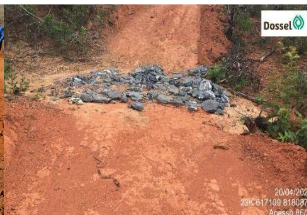
Foto 3-10: Passagem molhada em acesso. Fonte: Acervo Dossel, 2020.
