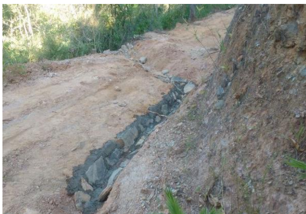
Foto 3.3-3: Exemplo de um sistema de drenagem pluvial (sarjeta) instalado em uma via de acesso localizada em terreno com alta declividade. Fonte: Acervo Dossel, 2017.
