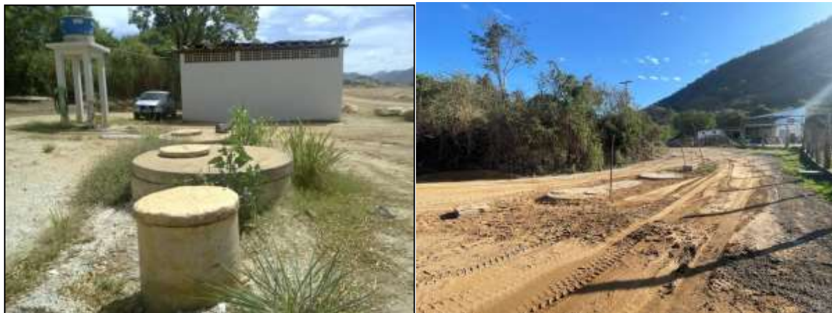
Figura 1.10.2.6.5-1: Sistema de tratamento de esgoto sanitário da estrutura de apoio dos trabalhadores da cava e oficina de automotivos.
