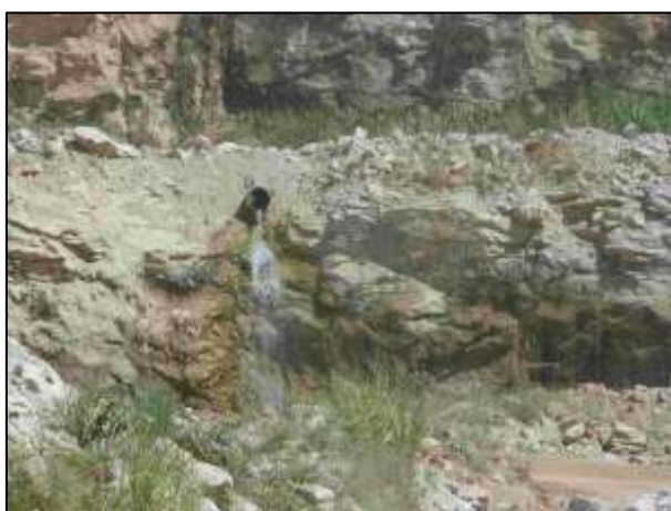
Figura 1.10.2.3-4: Foto da tubulação a jusante da foto anterior – estrada de acesso a Cava 1, logo acima da tubulação.
