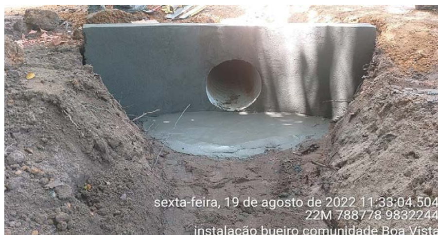
Figura 08: Modelo de construção de rede de drenagem (Bueiro).
