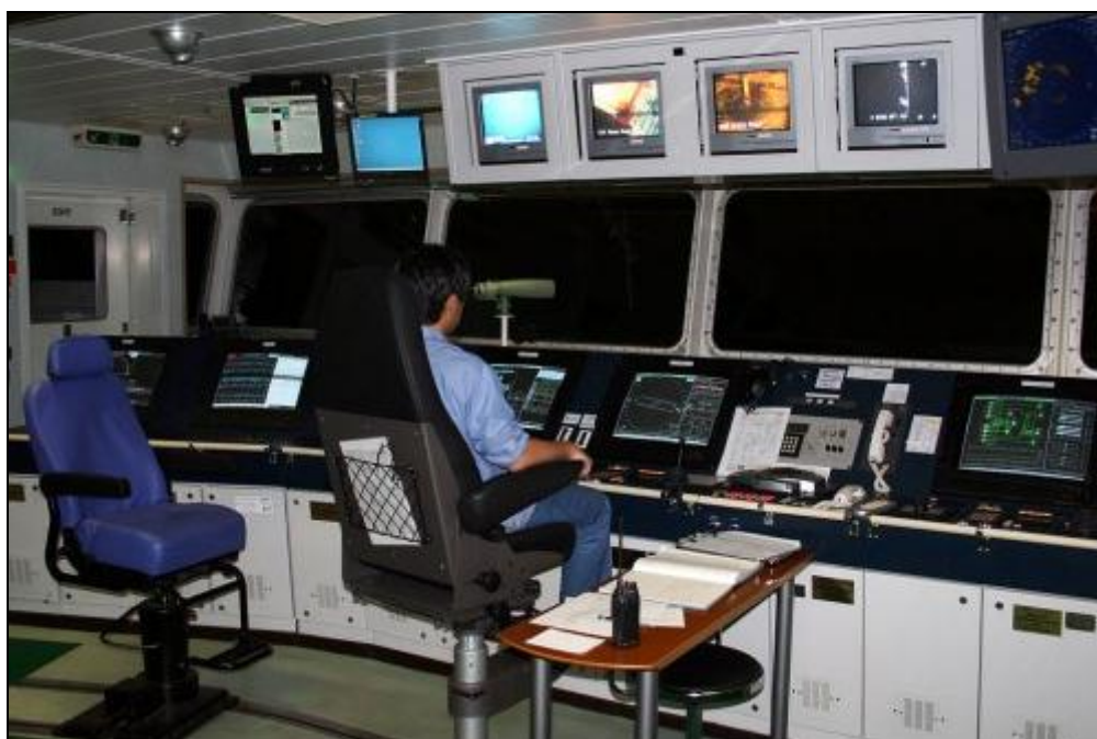
Figura 3-21: Painel de Controle do Sistema de Posicionamento Dinâmico. Fonte: Liquiport.
