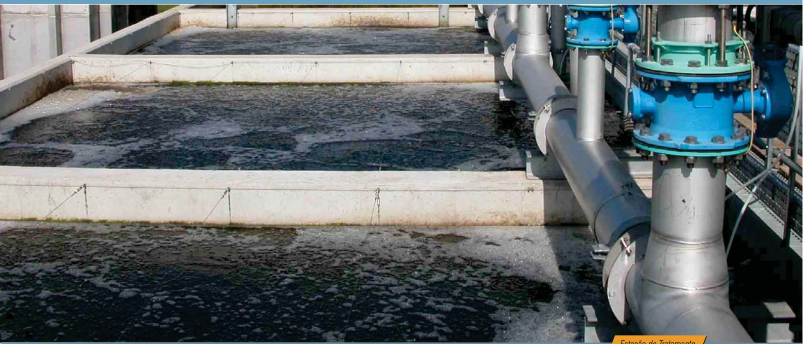
Estação de Tratamento
