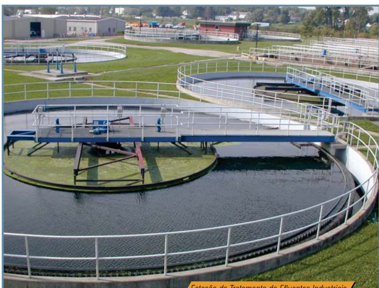
Estação de Tratamento de Efluentes Industriais
