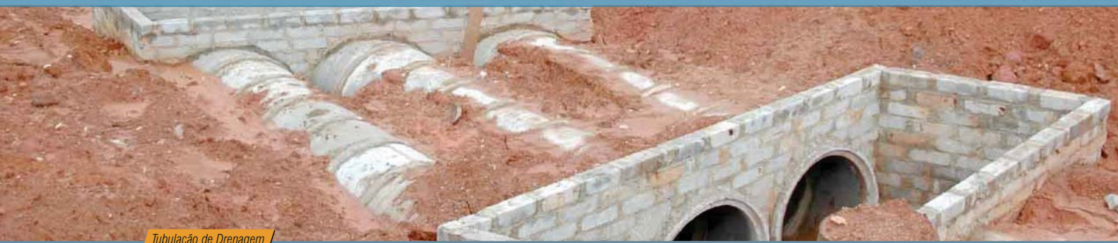
Tubulação de Drenagem
