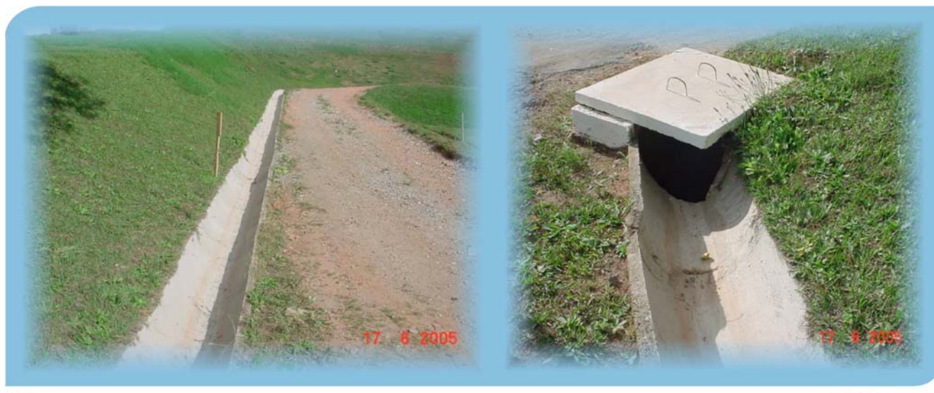
Figura 6: Sistema de drenagem de águas pluviais
