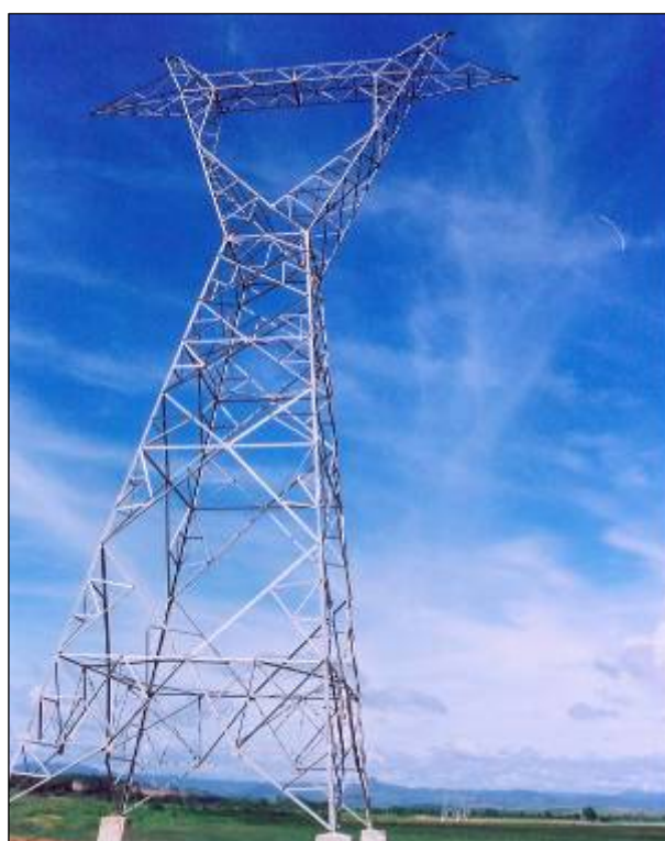
Figura 3.5-4: Vista aproximada da implantação das torres da Linha de Transmissão Ouro Preto Vitória de Furnas Centrais Elétricas no interior da área do Empreendimento.
