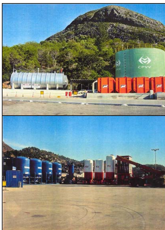
Figura 2-17 - Tanques de armazenamento no interior da CPVV.
