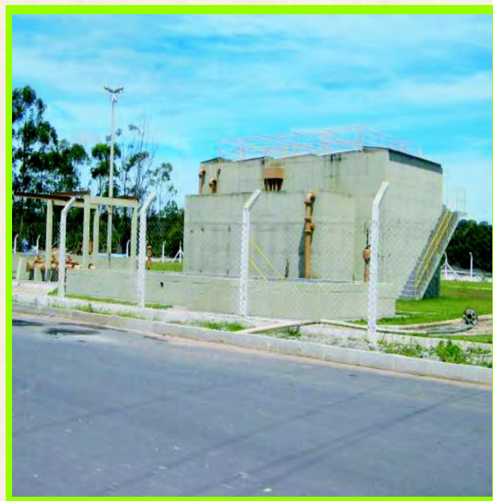
Fig. 34: Estação de Tratamento de Esgoto, Anchieta-ES.
