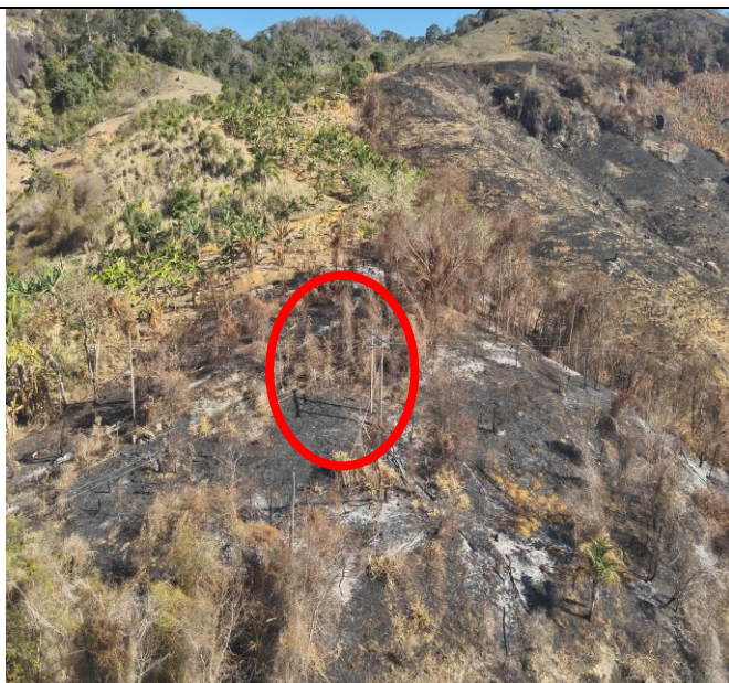
Vista da rede elétrica da provável origem do sinistro
