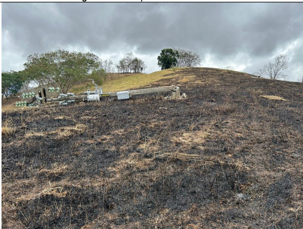
Figura 04: Poste caído na área queimada
