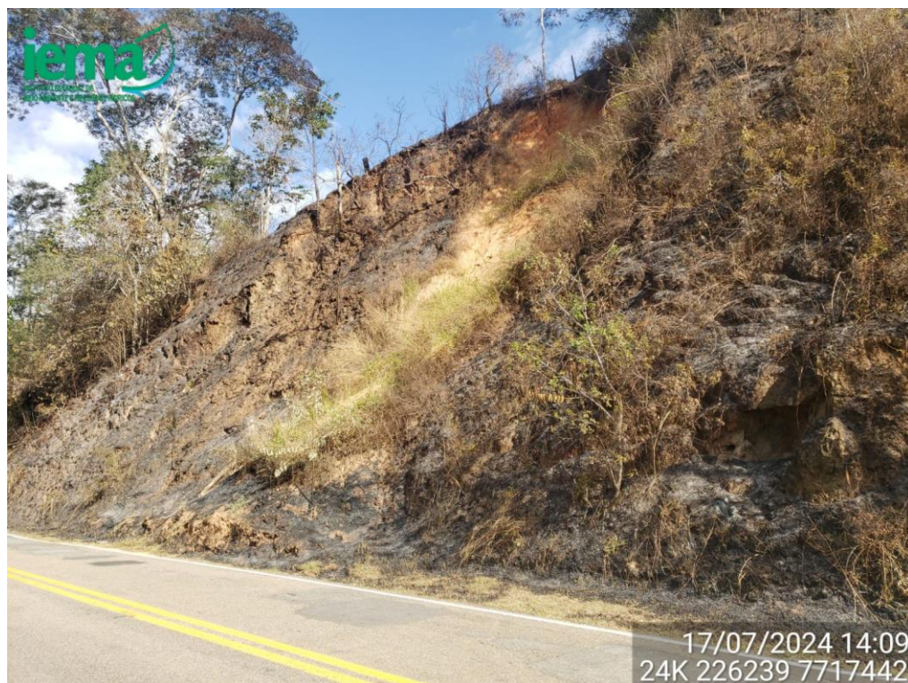
Foto 02. Área queimada às margens da rodovia.
