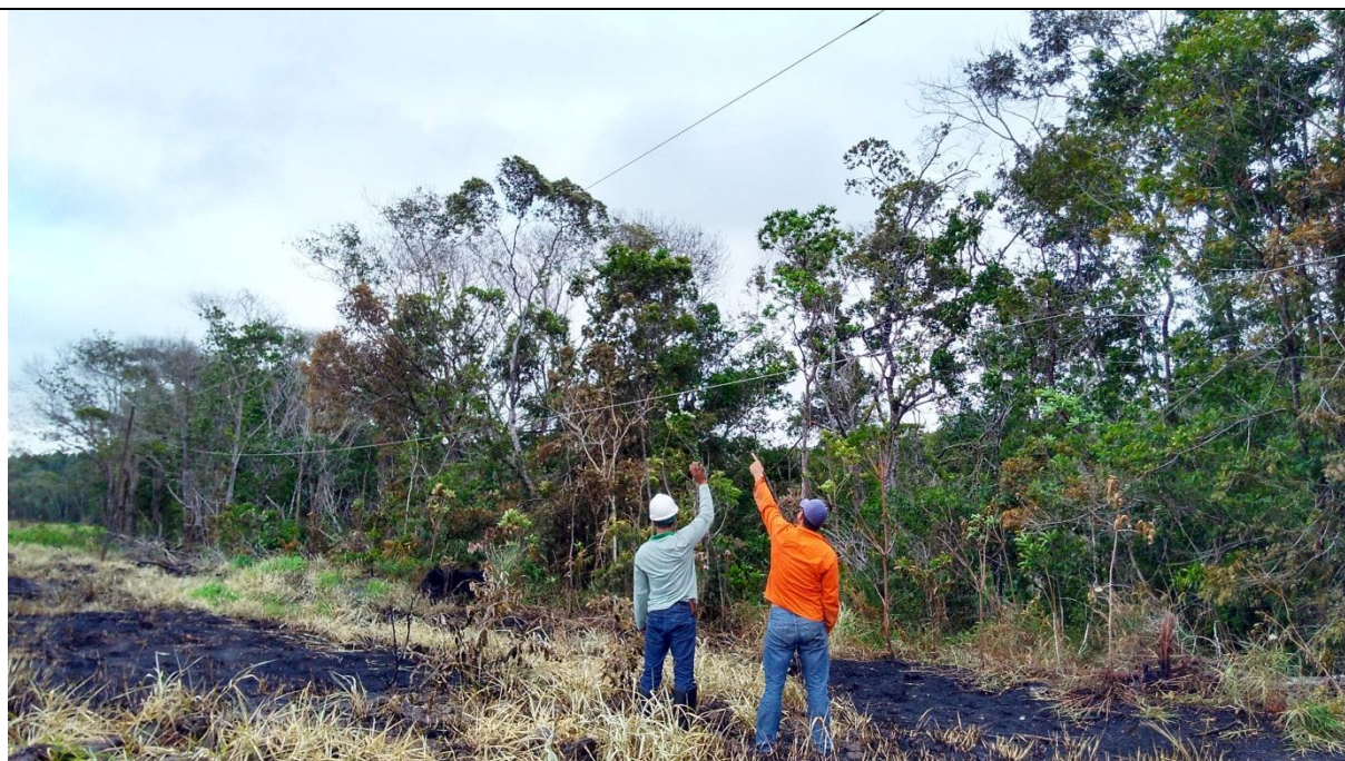
Figura 18: Detalhe da rede de transmissão de energia elétrica com fiação extremamente rebaixada.
