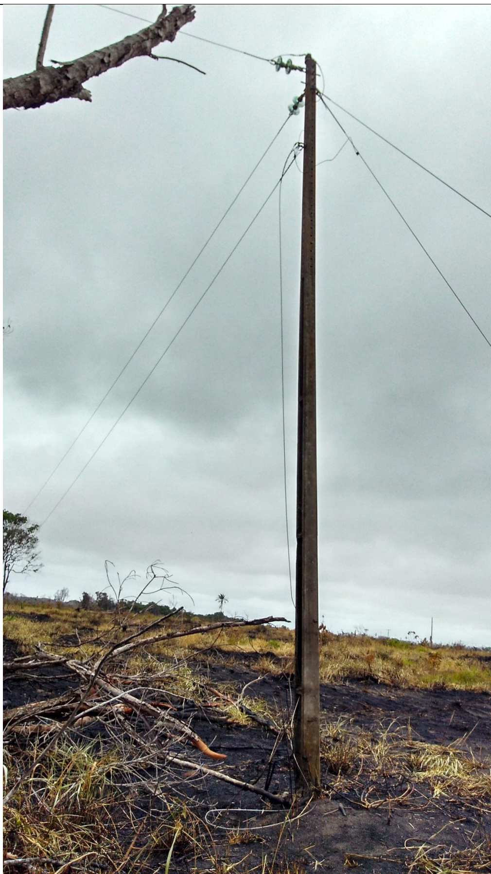
Figura 15: Detalhe do poste com fio de transmissão de energia elétrica solto sobre a vegetação, no local onde se iniciou o incêndio.
