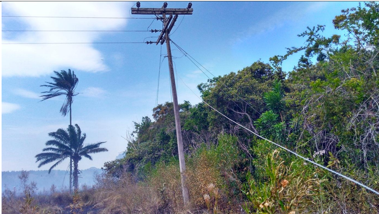
Figura 12: Detalhe da rede de energia elétrica com fios soltos.
