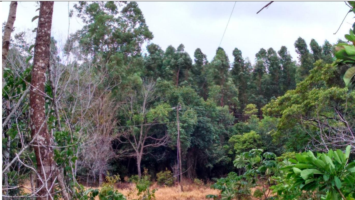
Figura 14: Fio da rede de transmissão de energia elétrica solto sobre a vegetação.
