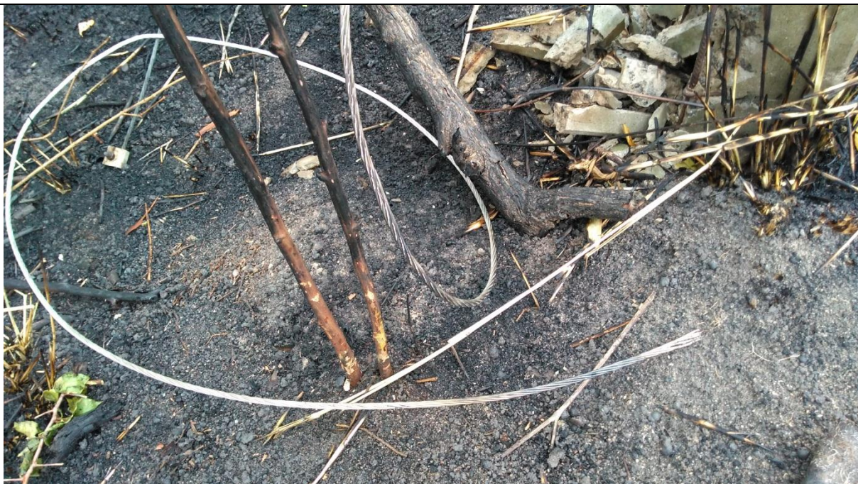
Figura 16: Fio da rede de transmissão de energia elétrica solto no chão, próximo ao poste, na região onde deu início ao incêndio.
