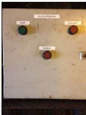
Figura 2 – Painel de acionamento da válvula rotativa
