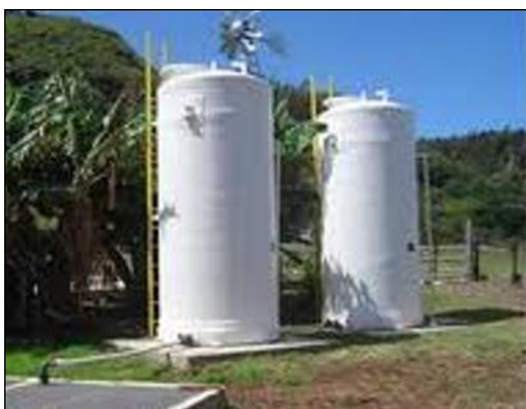
Figura 2.5.2.1.8-2: Vista externa do reator UASB.
