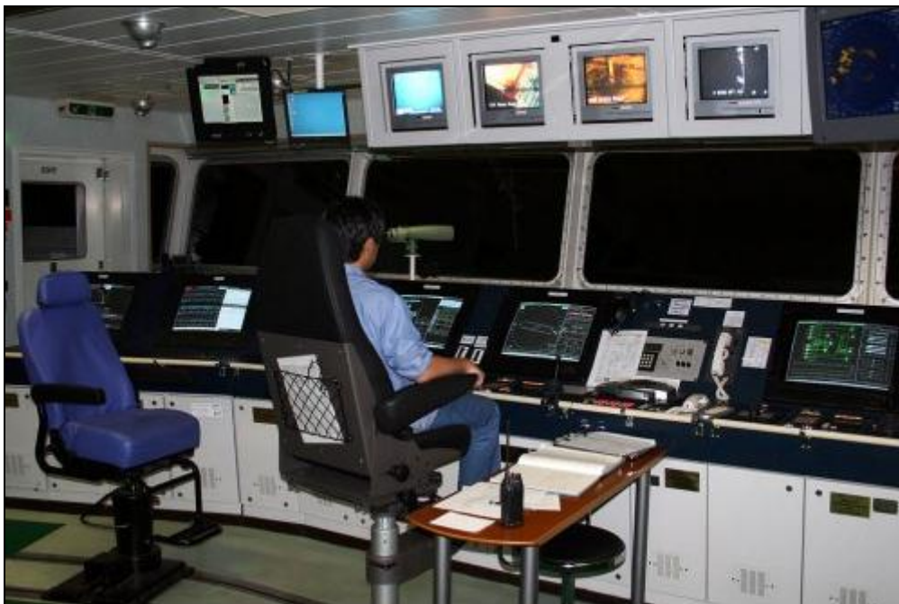
Figura 2.5.1.2-2: Painel de Controle do Sistema de Posicionamento Dinâmico. Fonte: LiquiPort.
