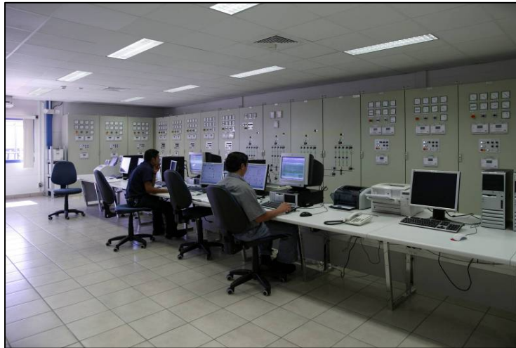
Figura 2.2.2-3: Vista Geral da Sala de Controle.
