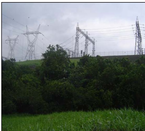
Figura 4.2.1.5-11: Vegetação em estágio médio na faixa de servidão da linha de transmissão.
