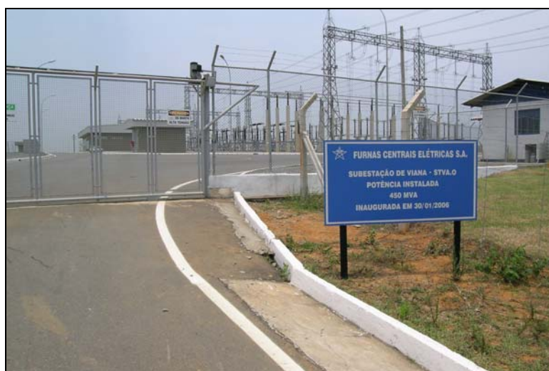
Figura 4.1.3.1-8: Ponto de Localização 7 - Furnas Subestação Elétrica.
