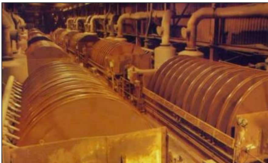
Figura 1.1.6.1-6: Vista dos Filtros a Vácuo
