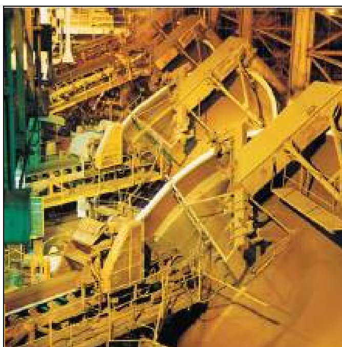
Figura 1.1.6.1-9: Vista dos Discos de Pelotamento
