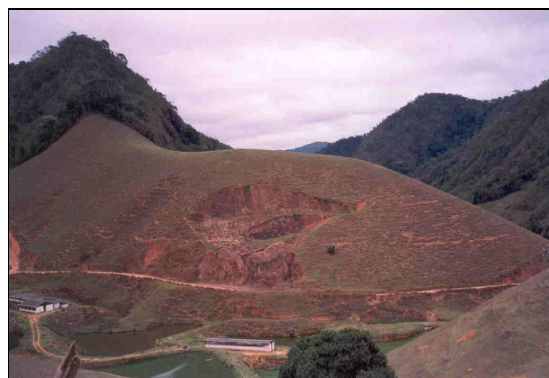
Figura 4.1.3.2.6 - Grande escorregamento próximo à tomada d'água.
