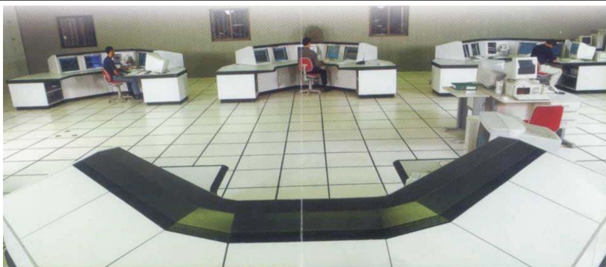
Foto 2.12 – Centro de Controle dos Dutos da Transpetro.
