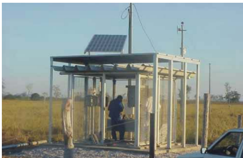
Foto 2.1 – Eemplo de Proteção Catódica.
