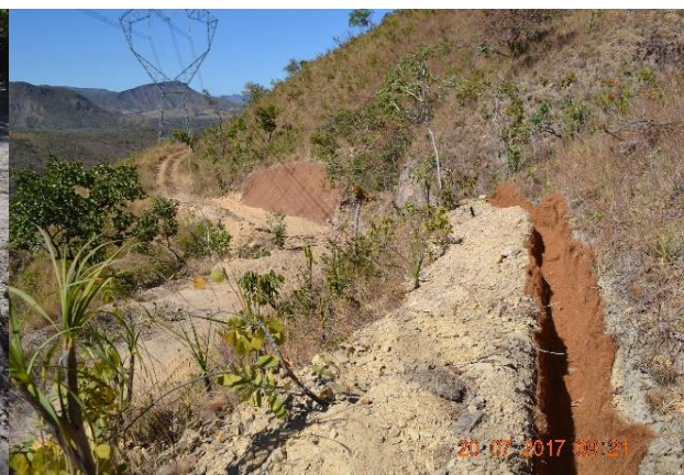
Foto 1-2: Exemplo de sistema de drenagem pluvial (canaleta de crista) instalado em talude. Fonte: Acervo Dossel, 2017.
