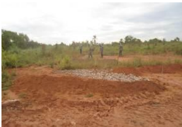
Foto 1-13: Dissipadores de energia (murundus) construídos para dividir as águas no percurso até as canaletas localizadas nas laterais do bota-fora. Fonte: Acervo Dossel, 2015.
