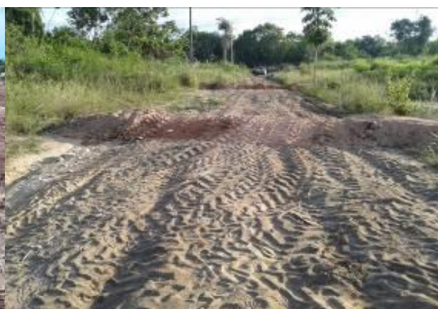
Foto 1-10: Área de canteiro de obras desmobilizado. Construção de camalhão para desvio d'água para as áreas vegetadas concluídas. Fonte: Acervo Dossel, 2015.
