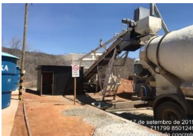
Foto 1-5: Placa de sinalização presente em central dosadora. Fonte: Acervo Dossel, 2019.
