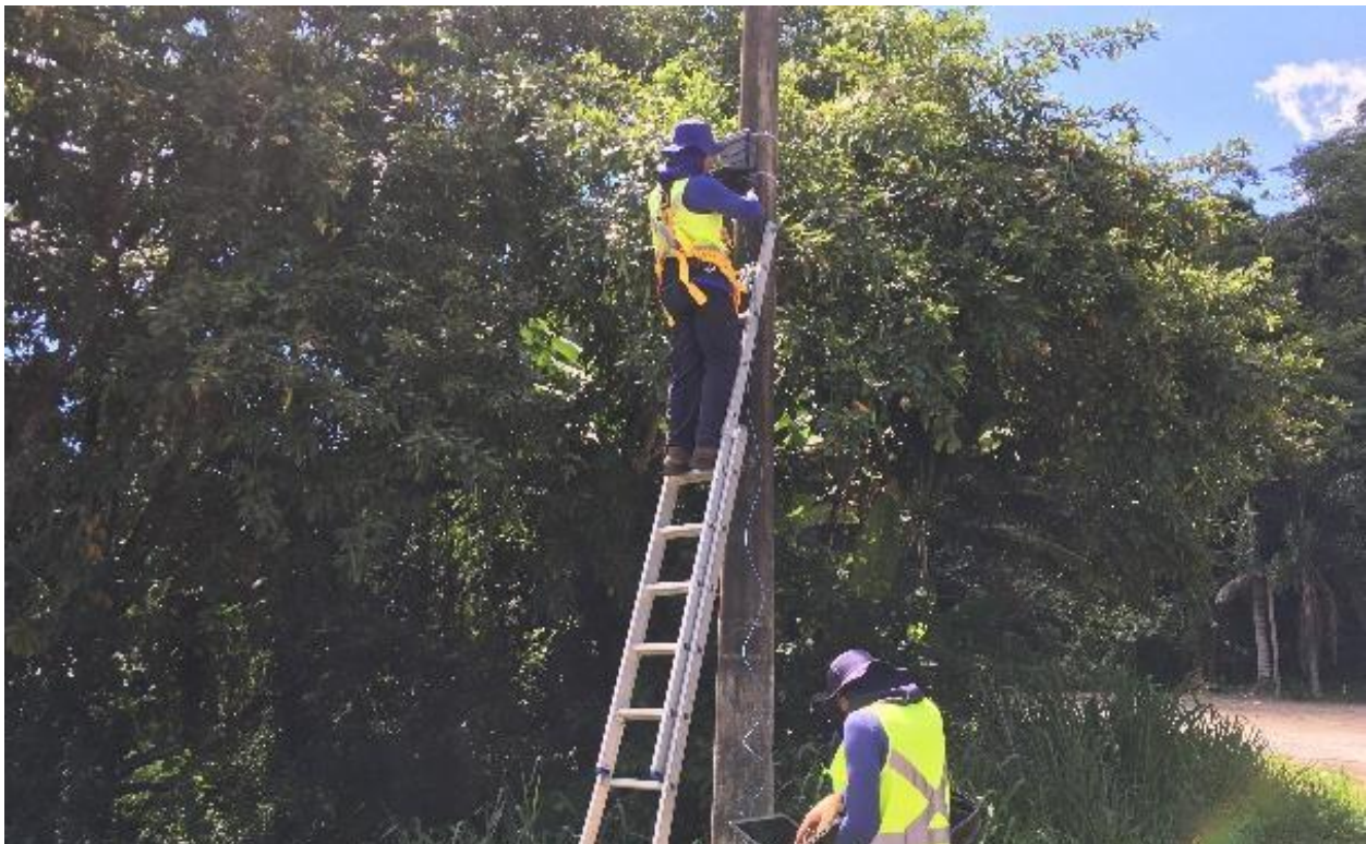
Figura 2: Instalação do módulo de filmagem de tráfego na interseção 06.
