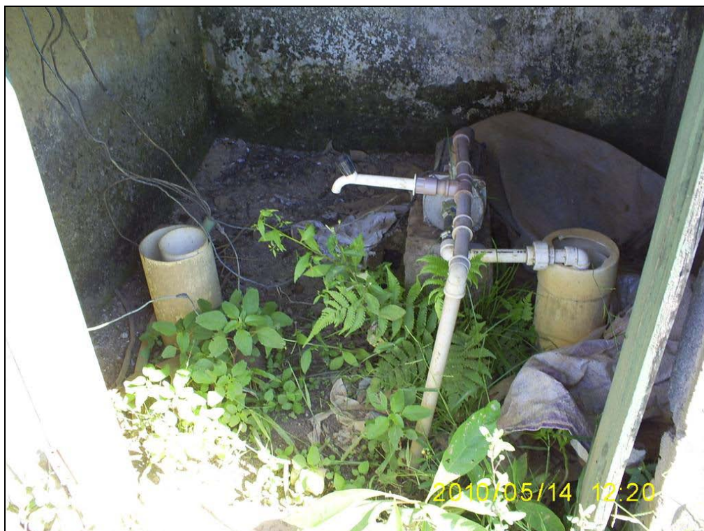
Figura 3.9.1 – Estrutura de poço de captação de água bruta da Fazenda Ilha do Sereno na AID do Empreendimento.
