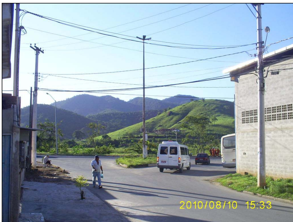
Figura 3.9.2 – Estrutura da rede de energia elétrica na Zona Urbana Metropolitana Sul do município de Viana.
