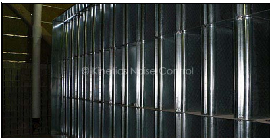
Figura 1.19.4 - Silenciosos típicos para ar da entrada de uma casa de força.
