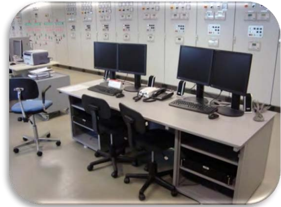
Figura 8 – Sala de controle Foto: Marcelo Lopes Dalbom
