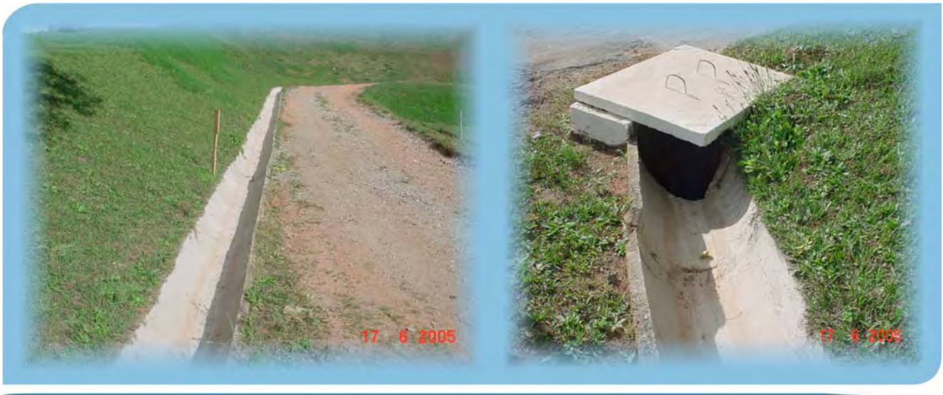
Figura 6: Sistema de drenagem de águas pluviais
