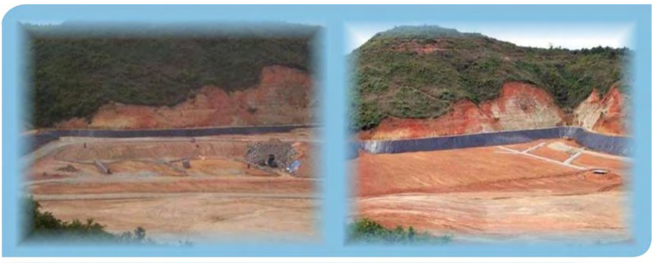
Figuras 7: Drenagem de percolados na base em empreendimentos semelhantes ao CTR Colatina.
