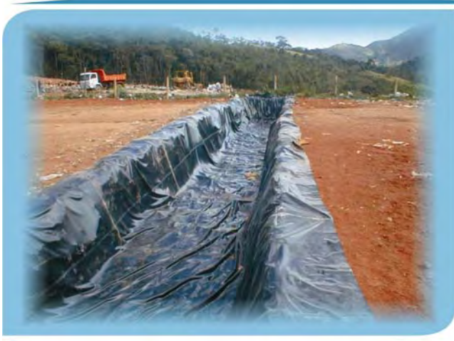
Figura 4: Sistema de impermeabilização nos canais de drenagem.
