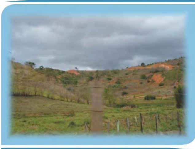
Figura 13: Encostas na área de estudo e arredores onde ocorrem erosões em função de cortes de taludes desmatamento – UTM 0327326 / 7843444 – WGS 84. (Fonte: Vereda, 2009).
