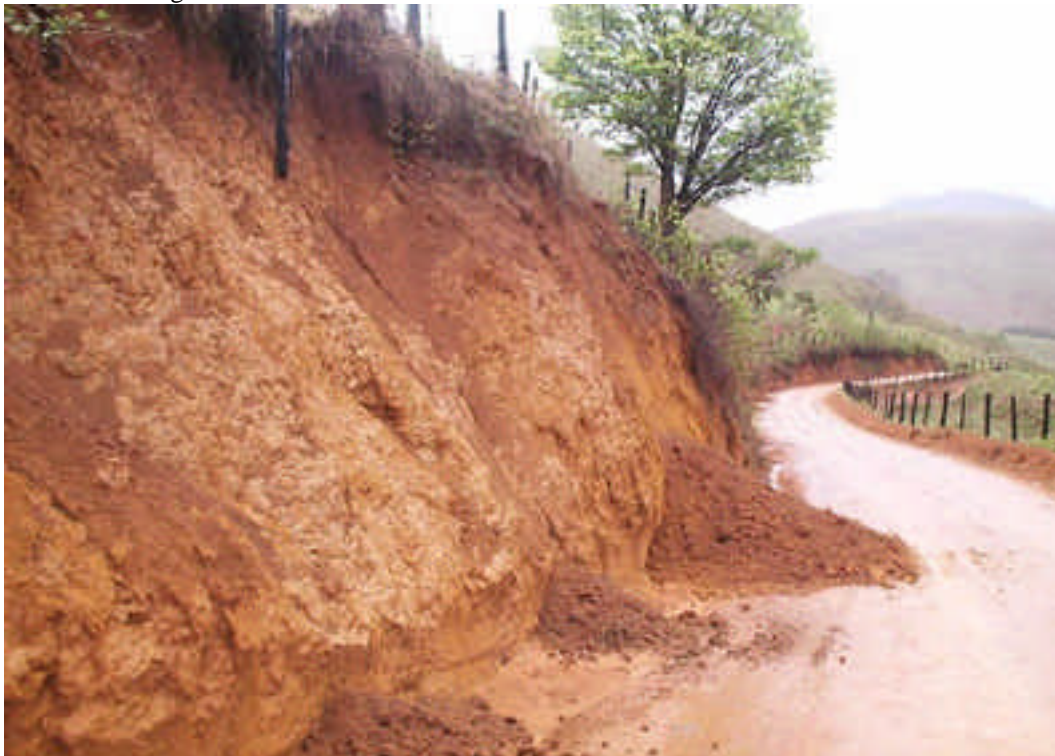
FOTO 08 – Aspectos de pequenos desbarrancamentos que se desenvolvem nos taludes dos cortes das estradas vicinais. É indicada a implantação de proteção com enrocamento, nos trechos dos taludes das estradas a serem inundados prevenindo o desencadeamento e o desenvolvimento de processos erosivos mais acentuados.
