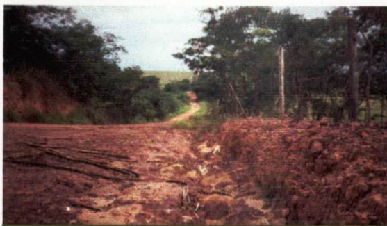
Erosão Superficial em área de tabuleiro
