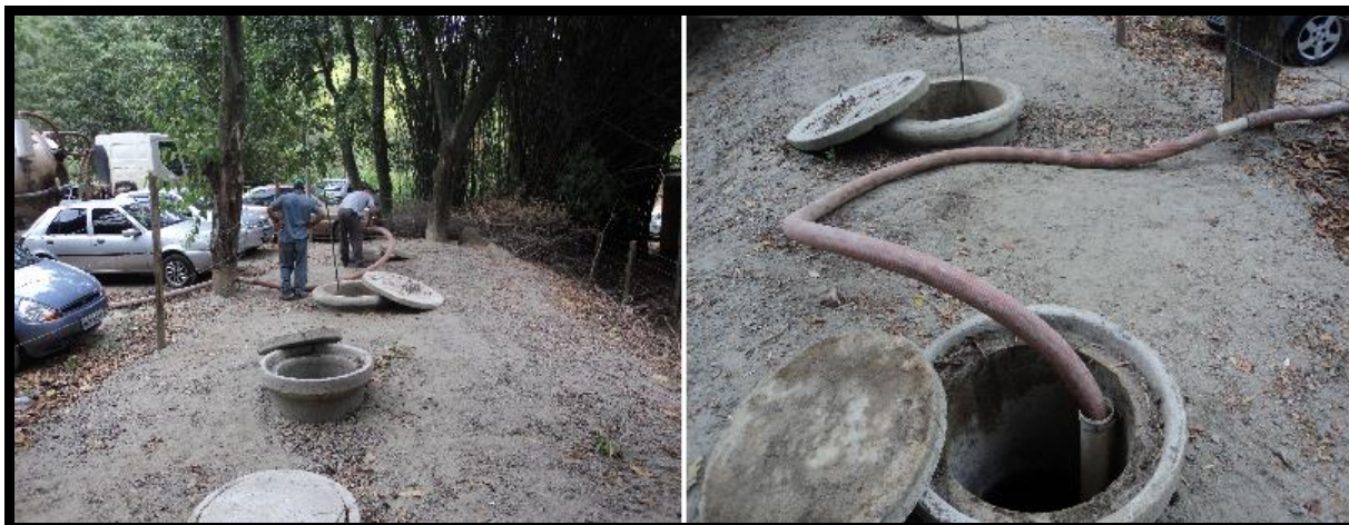
Fotos: Sistema de Tratamento de Efluentes Domésticos onde podemos verificar a limpeza do mesmo.
