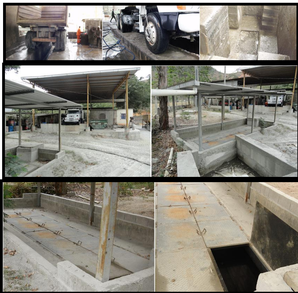
Fotos: Detalhes do Sistema Separador de Água e Óleo - SAO.
