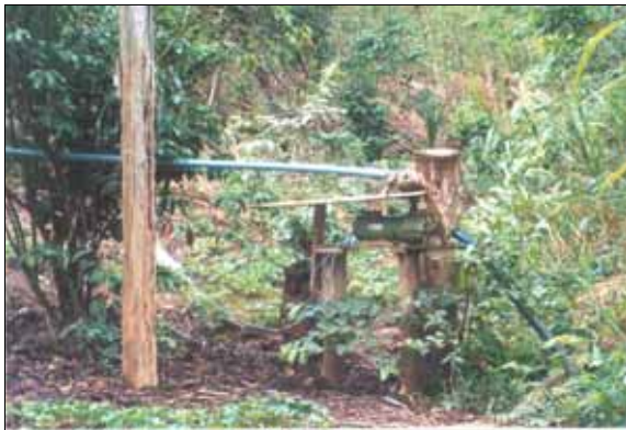
Bomba instalada às margens do rio Guandu para sucção da água para irrigação.
