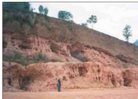
Corte de estrada, ao lado da ponte sobre o rio Guandu, em estágio erosivo avançado.
