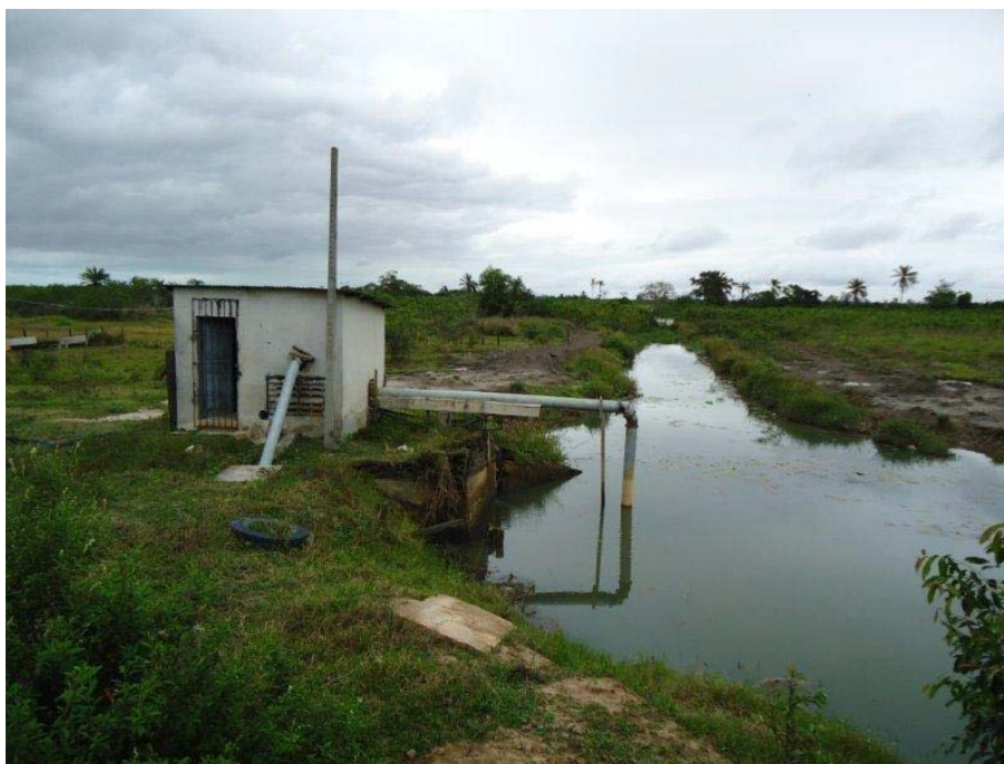
Foto 2.1.4.3-72 -P13-4 - 414655/7932996 – Casa de bomba de irrigação localizada em poço de canal afluente do rio São Mateus ou Cricaré, em propriedade rural, ao sul da APA.
