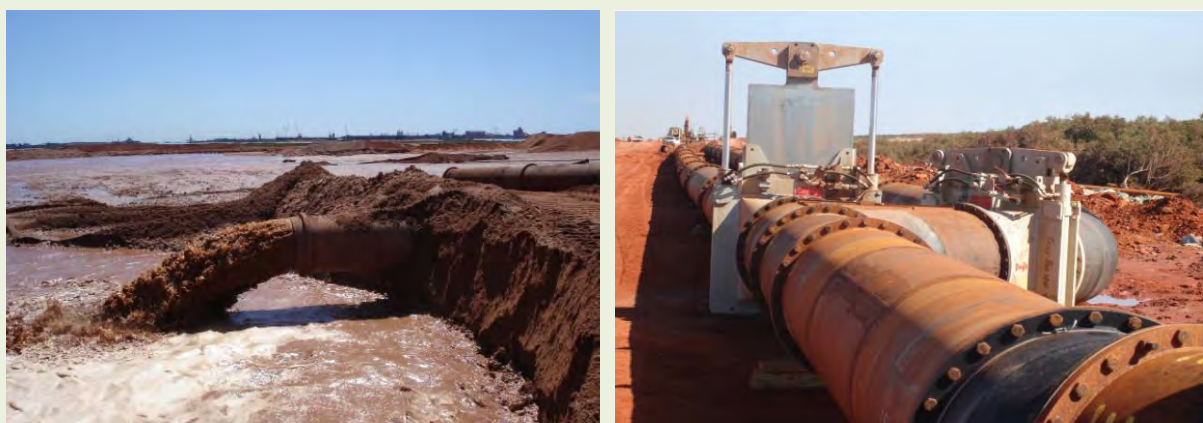
Figura 5.3.2.7-14: Tubulações com descarga de sedimentos.
