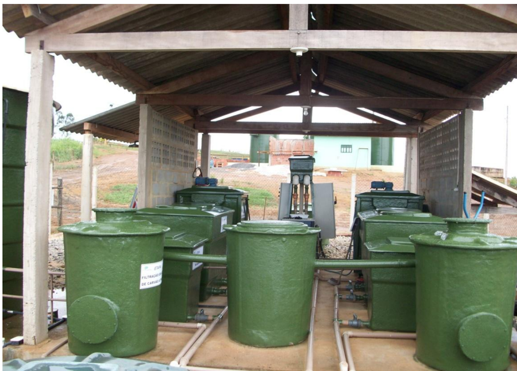
Figura 6.4-6 – Modelo de estação de tratamento utilizada pela Brasil Ambiental Tratamento de Resíduos S.A.
