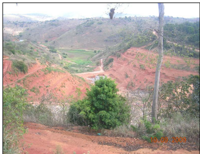
Figura 7.3.8-4: Vista da área do empreendimento já implantado. Observar remoção de solo nas encostas, aterro no vale e área alagada ao fundo.
