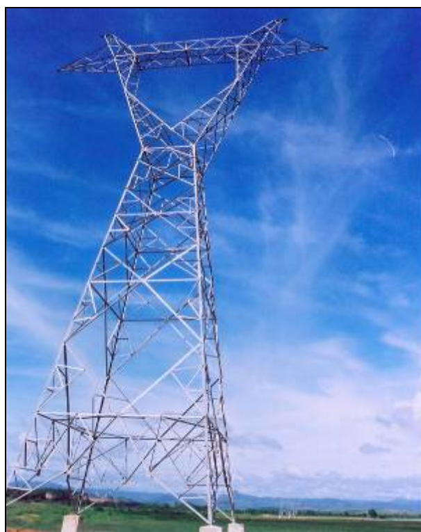
Figura 3.1.4.4.1-4: Vista aproximada da implantação das torres da Linha de Transmissão Ouro Preto Vitória de FURNAS Centrais Elétricas no interior da área do Empreendimento.
