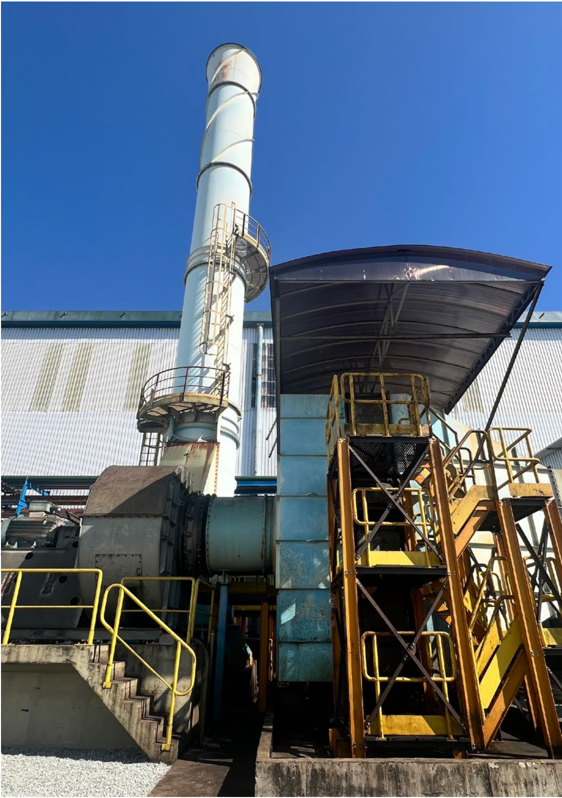
Sistema de tratamento de emissões atmosféricas
