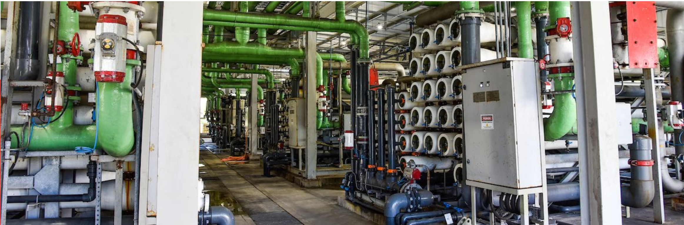
Planta de Dessalinização da Água do Mar da ArcelorMittal Tubarão
