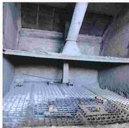
Figura 8 – Moega com vazador para descarga de materiais com captação
