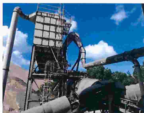
Figura 10 – Silos dosadores providos de filtros de mangas
