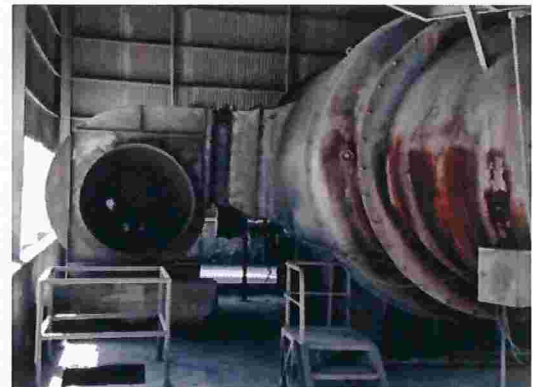
Figura 16 – Sistema de aquecimento de gases com deterioração
