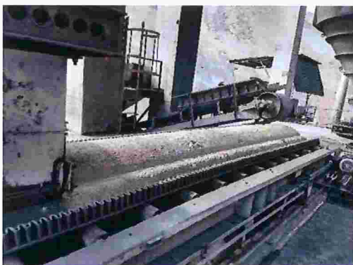
Figura 11 – Depósito de particulado no interior da unidade de silo e dosagem de materiais
