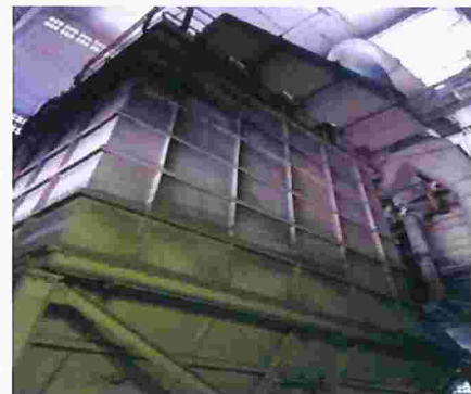
Figura 22 – Detalhe do filtro de mangas da área de ensaque
