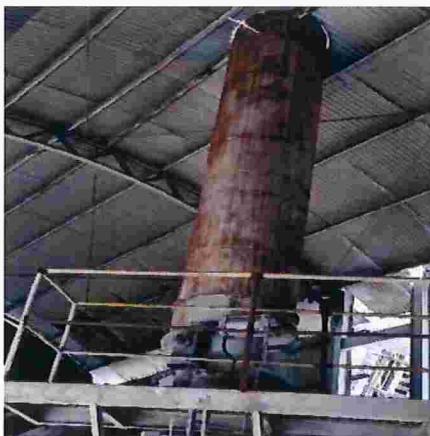
Figura 17 – Dutos de gases quentes com deterioração
