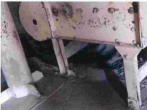
Figura 21 – Detalhe de acúmulo de particulado no piso
