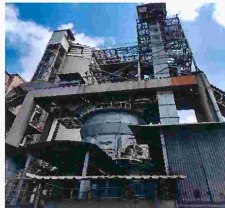
Figura 14 – Sistema de resfriamento/aquecimento dos gases
