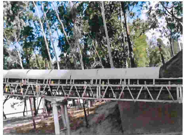
Figura 2 – Acúmulo de material na parte inferior da correia transportadora provida de cobertura, sem contenção lateral e bandejamento
