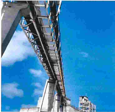
Figura 1 – Detalhe de correia transportadora sem cobertura, contenção lateral e bandejamento
