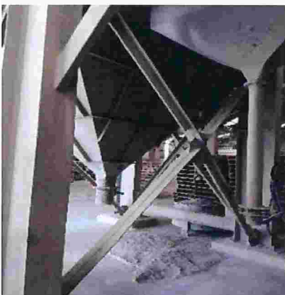
Figura 23 – Acúmulo de material no piso do galpão de ensaque
