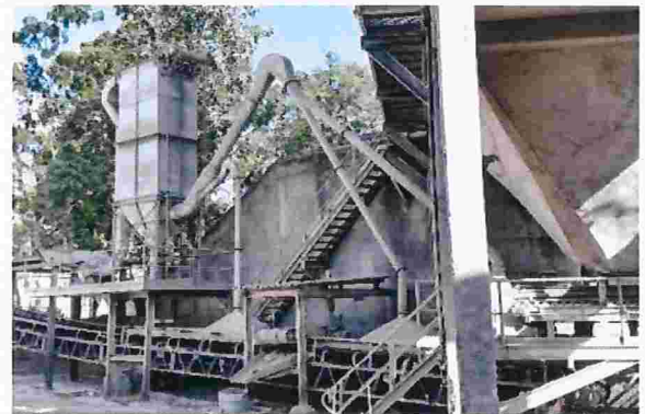
Figura 4 – Moega principal provida de sistema de captação e filtro de mangas com material depositado na estrutura e no solo
