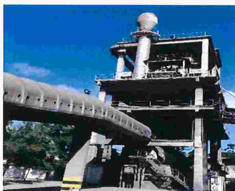
Figura 12 – Detalhe de correia transportadora provida de cobertura e contenção lateral
