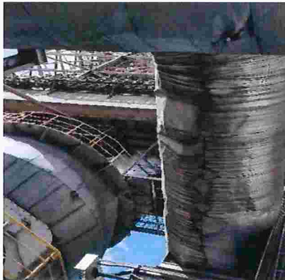
Figura 15 – Dutos de gases em mau estado de conservação
