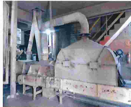
Figura 20 – Sistema de captação do ensaque com deterioração
