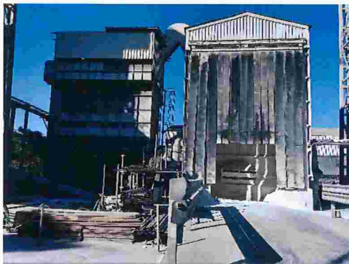
Figura 13 – Cabine de recebimento de cal provida de cortina de borracha, sistema de captação e filtro de mangas.
