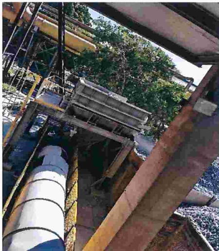
Figura 03 – O material é carregado em moega e segue por correia transportadora, observado acúmulo de pó nas estruturas.
