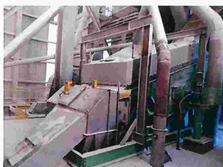
Figura 10 - Pó depositado nos equipamentos (peneira), estruturas e piso.
