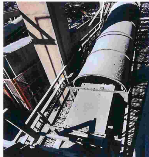
Figura 04 – Correia transportadora do pátio de materiais com acúmulo de pó
