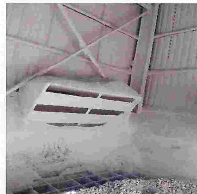
Figura 14 – Acúmulo de material no vazador e no captor
