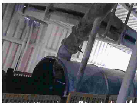
Figura 09 – Pontos de captação deficientes
