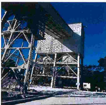
Figuras 15 – Silo de cal dolomítica e calcítica no limite de bateria entre a Arcelor e a Lhoist com acúmulo de pós no piso
