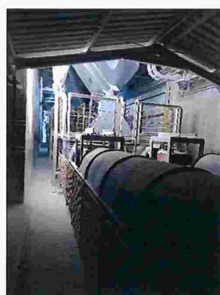
Figura 08 – Pó de cal depositada em todas as estruturas e piso do processo
